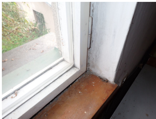
Vady a poruchy oken a dveří
