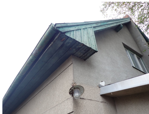
Vady a poruchy střechy a souvisejících konstrukcí
