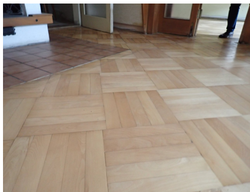
Vady a poruchy povrchů stěn a podlah
