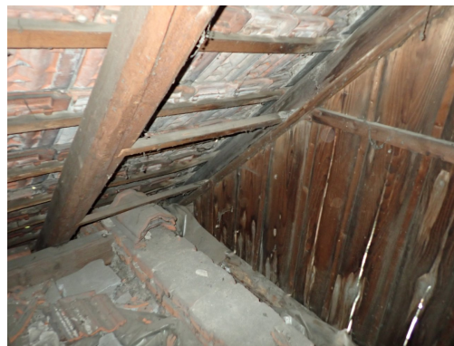
Vady a poruchy nosných konstrukcí
