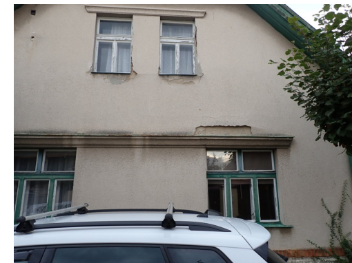
Vady a poruchy fasády
