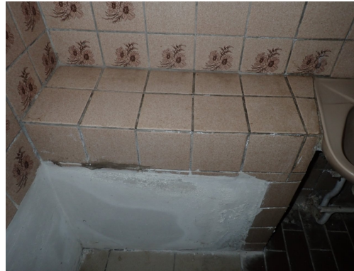
Vady a poruchy povrchů stěn a podlah
