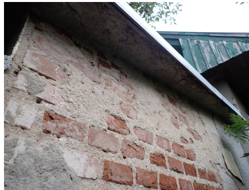
Vady a poruchy fasády
