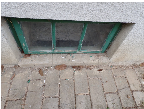
Vady a poruchy oken a dveří
