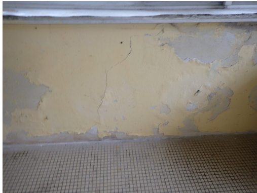
Vady a poruchy povrchů stěn a podlah
