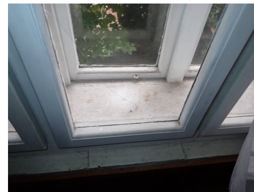
Vady a poruchy oken a dveří
