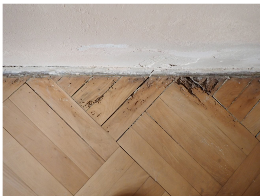
Vady a poruchy povrchů stěn a podlah
