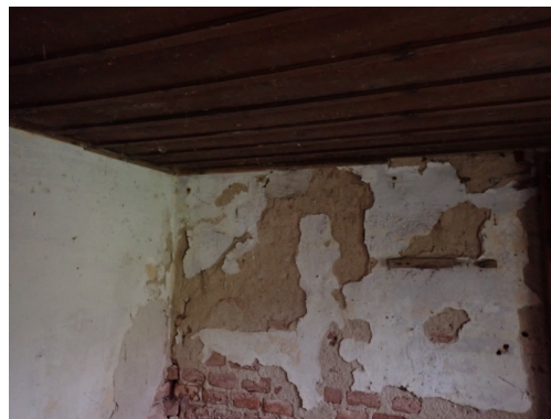
Vady a poruchy vedlejších staveb
