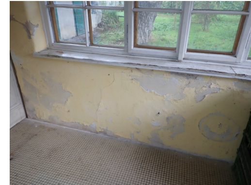
Vady a poruchy povrchů stěn a podlah
