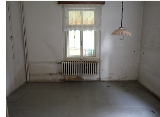
Vady a poruchy povrchů stěn a podlah
