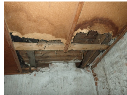
Vady a poruchy sklepa a garáže
