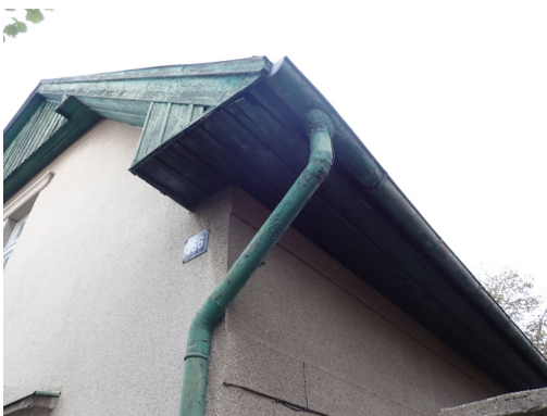
Vady a poruchy střechy a souvisejících konstrukcí
