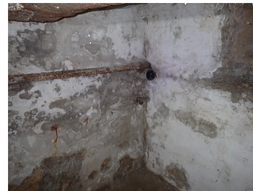
Vady a poruchy sklepa a garáže
