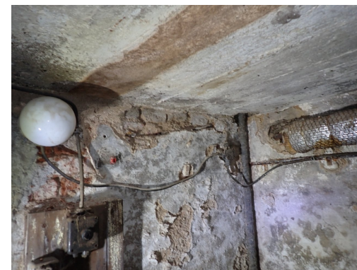
Vady a poruchy sklepa a garáže
