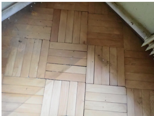
Vady a poruchy povrchů stěn a podlah
