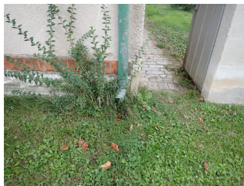
Vady a poruchy střechy a souvisejících konstrukcí
