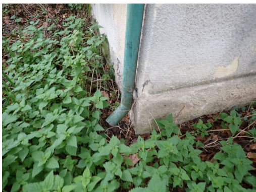
Vady a poruchy sklepa a garáže
