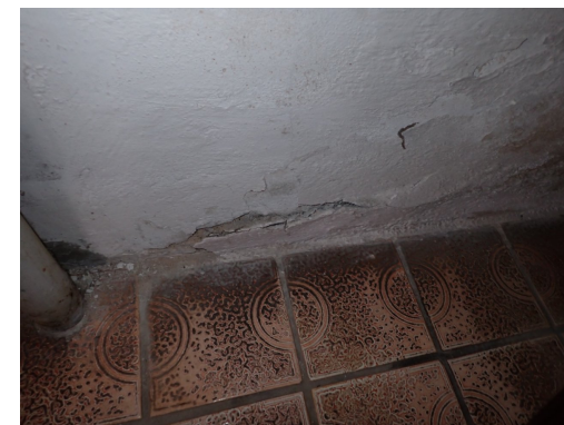
Vady a poruchy povrchů stěn a podlah
