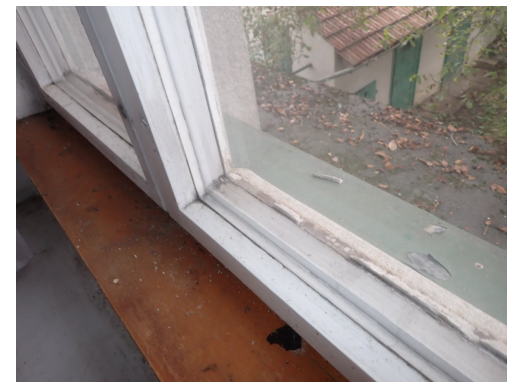
Vady a poruchy oken a dveří
