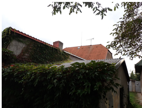
Vady a poruchy sklepa a garáže
