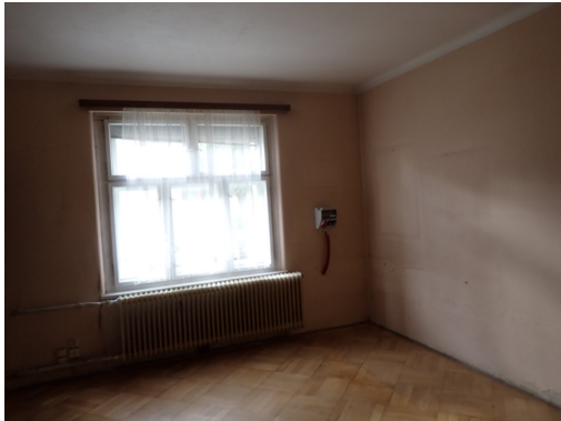
Vady a poruchy vnitřních instalací
