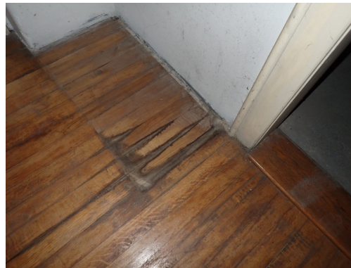
Vady a poruchy povrchů stěn a podlah
