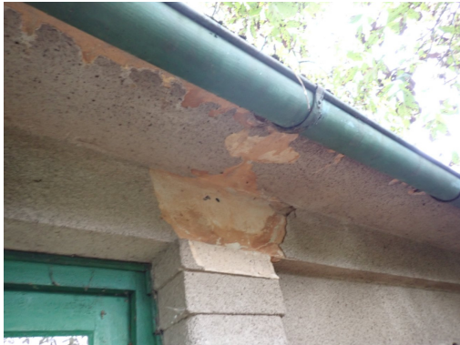
Vady a poruchy fasády
