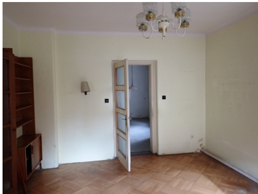
Vady a poruchy oken a dveří
