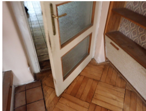
Vady a poruchy oken a dveří
