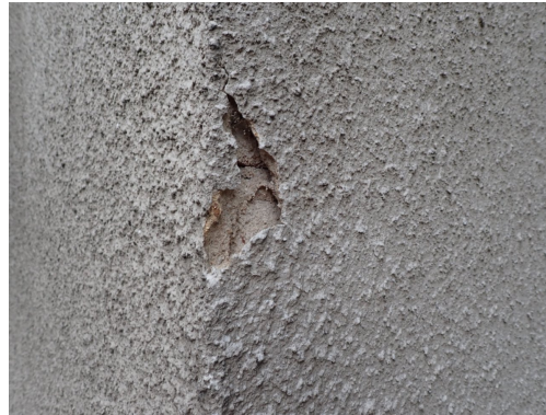
Vady a poruchy fasády
