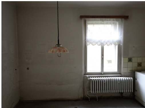
Vady a poruchy povrchů stěn a podlah
