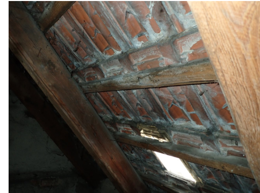
Vady a poruchy nosných konstrukcí
