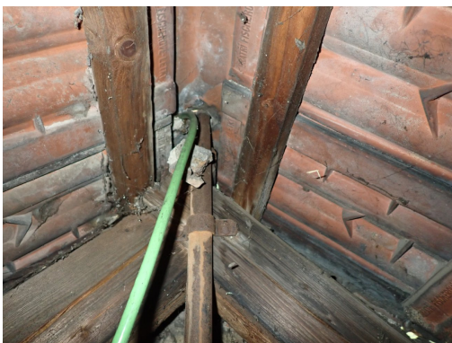
Vady a poruchy střechy a souvisejících konstrukcí
