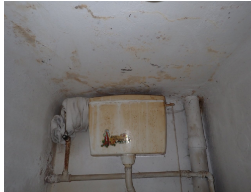
Vady a poruchy povrchů stěn a podlah
