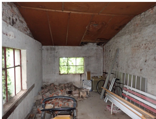
Vady a poruchy sklepa a garáže
