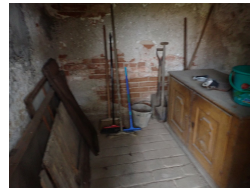
Vady a poruchy vedlejších staveb
