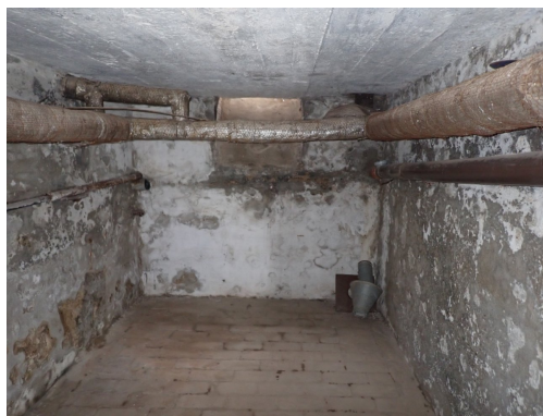
Vady a poruchy sklepa a garáže
