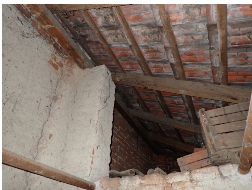
Vady a poruchy vedlejších staveb
