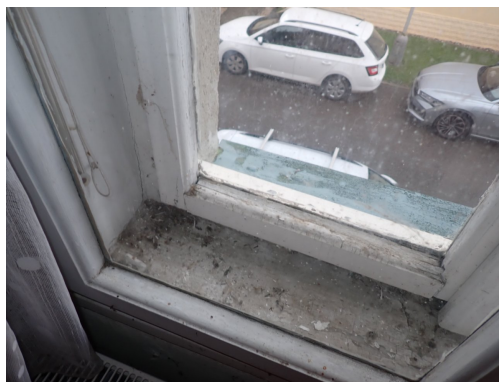
Vady a poruchy oken a dveří
