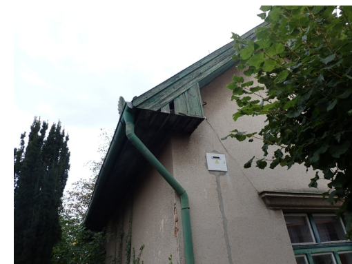
Vady a poruchy střechy a souvisejících konstrukcí
