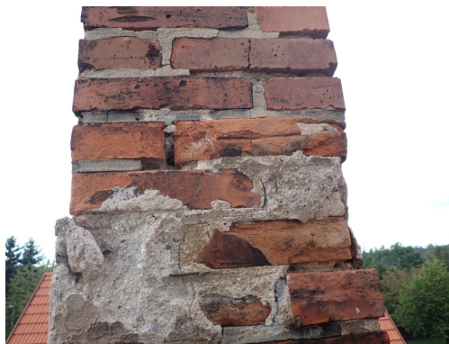
Vady a poruchy střechy a souvisejících konstrukcí
