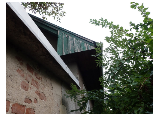
Vady a poruchy střechy a souvisejících konstrukcí
