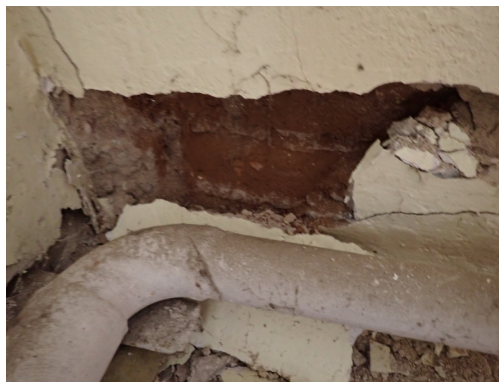
Vady a poruchy povrchů stěn a podlah
