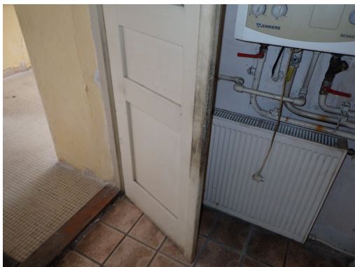
Vady a poruchy oken a dveří
