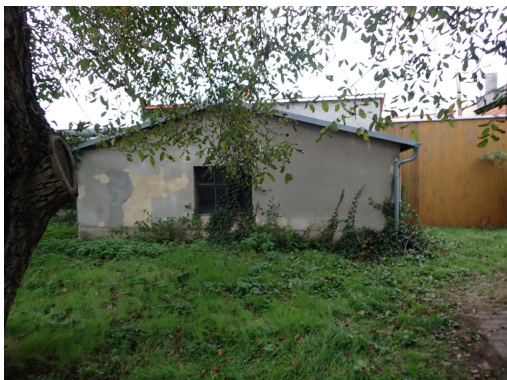
Vady a poruchy sklepa a garáže
