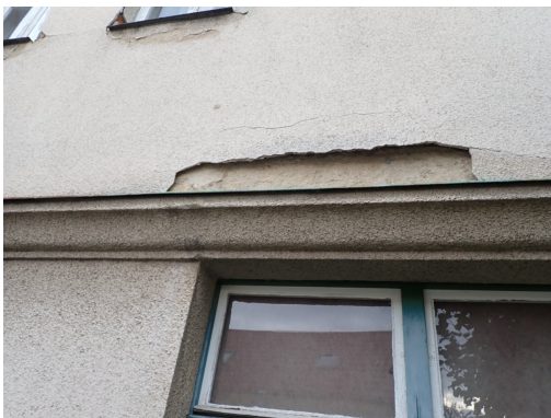
Vady a poruchy fasády
