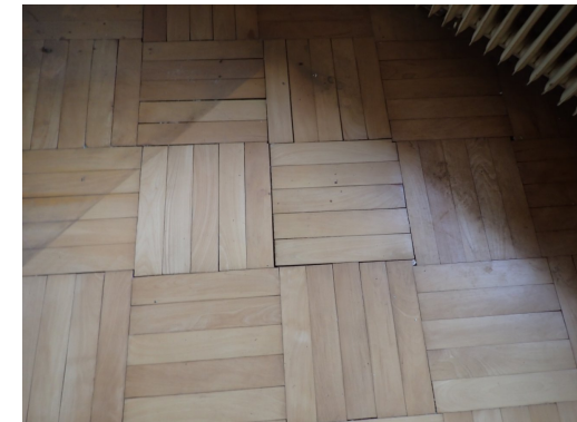
Vady a poruchy povrchů stěn a podlah
