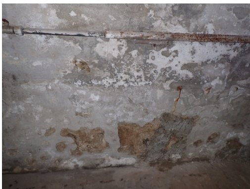
Vady a poruchy sklepa a garáže
