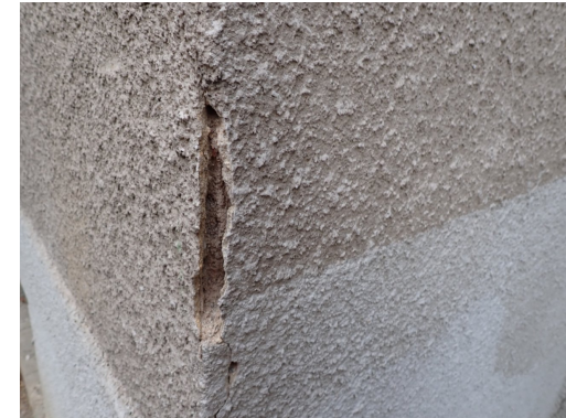
Vady a poruchy fasády
