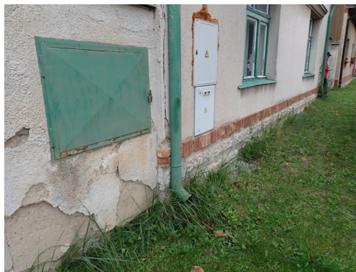
Vady a poruchy fasády
