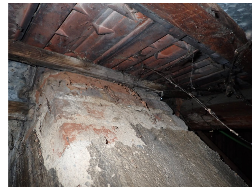
Vady a poruchy nosných konstrukcí
