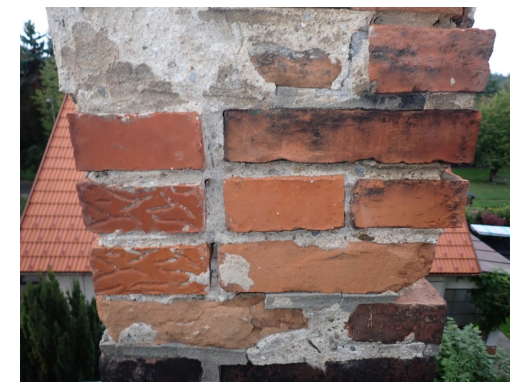
Vady a poruchy střechy a souvisejících konstrukcí
