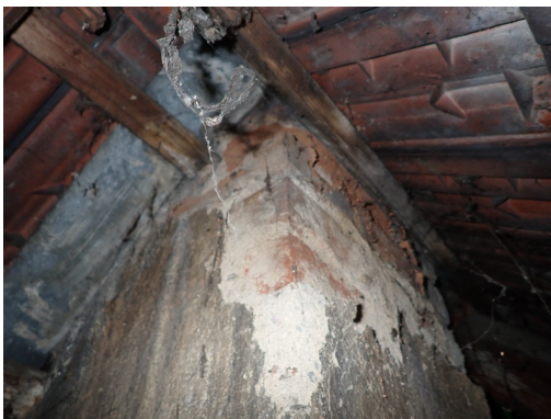
Vady a poruchy střechy a souvisejících konstrukcí
