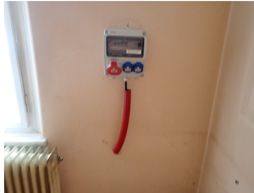
Vady a poruchy vnitřních instalací
