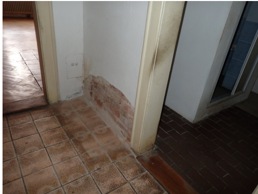
Vady a poruchy povrchů stěn a podlah
