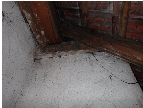
Vady a poruchy nosných konstrukcí
