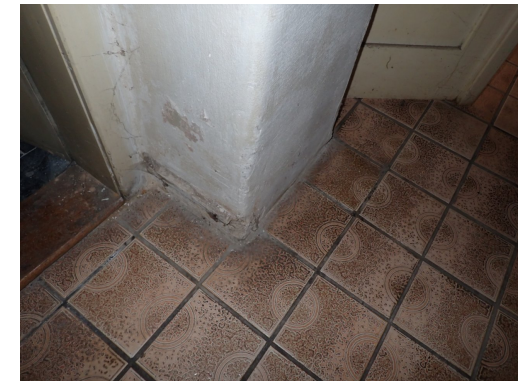
Vady a poruchy povrchů stěn a podlah
