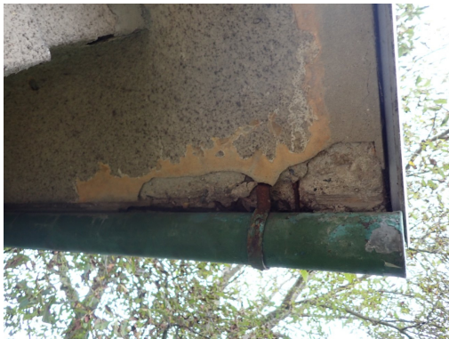
Vady a poruchy fasády
