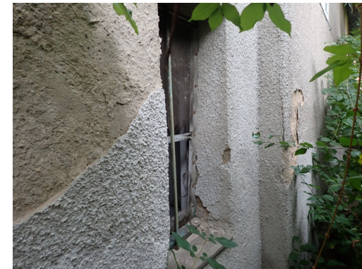
Vady a poruchy fasády
