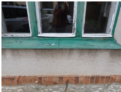
Vady a poruchy oken a dveří
