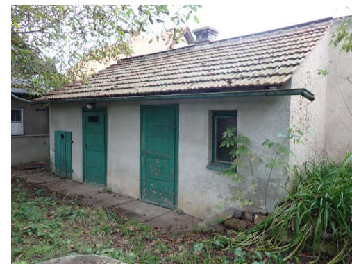
Vady a poruchy vedlejších staveb
