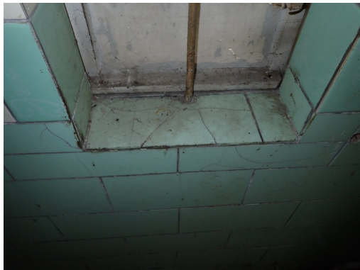
Vady a poruchy povrchů stěn a podlah
