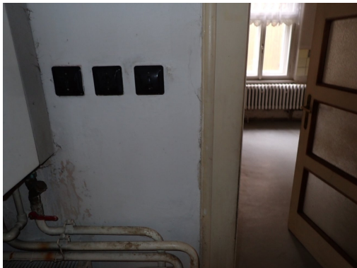
Vady a poruchy vnitřních instalací
