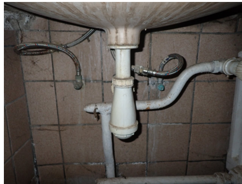
Vady a poruchy vnitřních instalací
