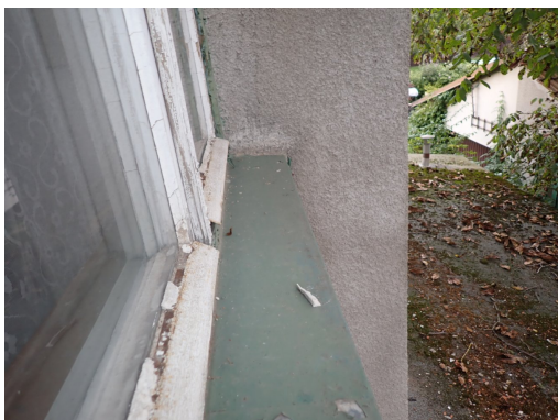
Vady a poruchy oken a dveří
