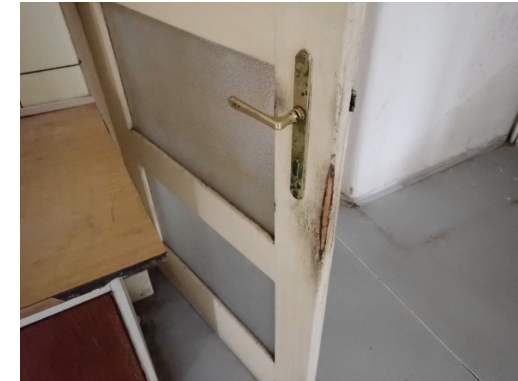
Vady a poruchy oken a dveří
