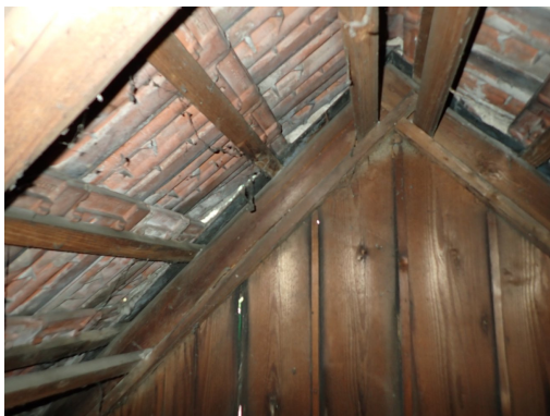
Vady a poruchy nosných konstrukcí
