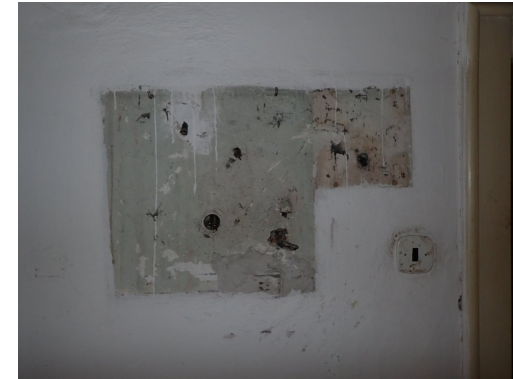
Vady a poruchy vnitřních instalací
