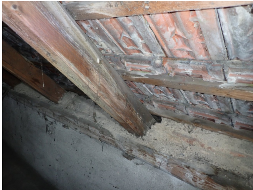
Vady a poruchy nosných konstrukcí
