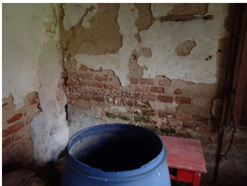
Vady a poruchy vedlejších staveb
