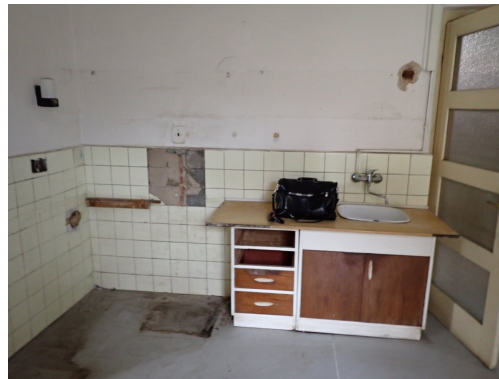
Vady a poruchy povrchů stěn a podlah
