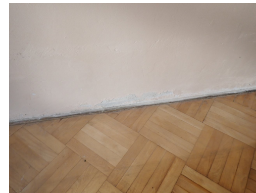
Vady a poruchy povrchů stěn a podlah
